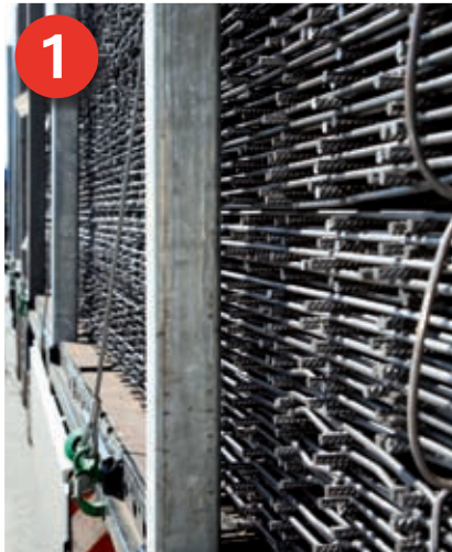
1 Lasi-Hilfe: Auf einem speziellen Fahrzeug können Betonstahlmatten in alle Richtungen formschlüssig z. B. durch Steckungen gesichert werden.
